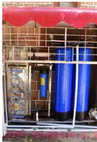
浄水設備 (盗難防止のため敷地内)
